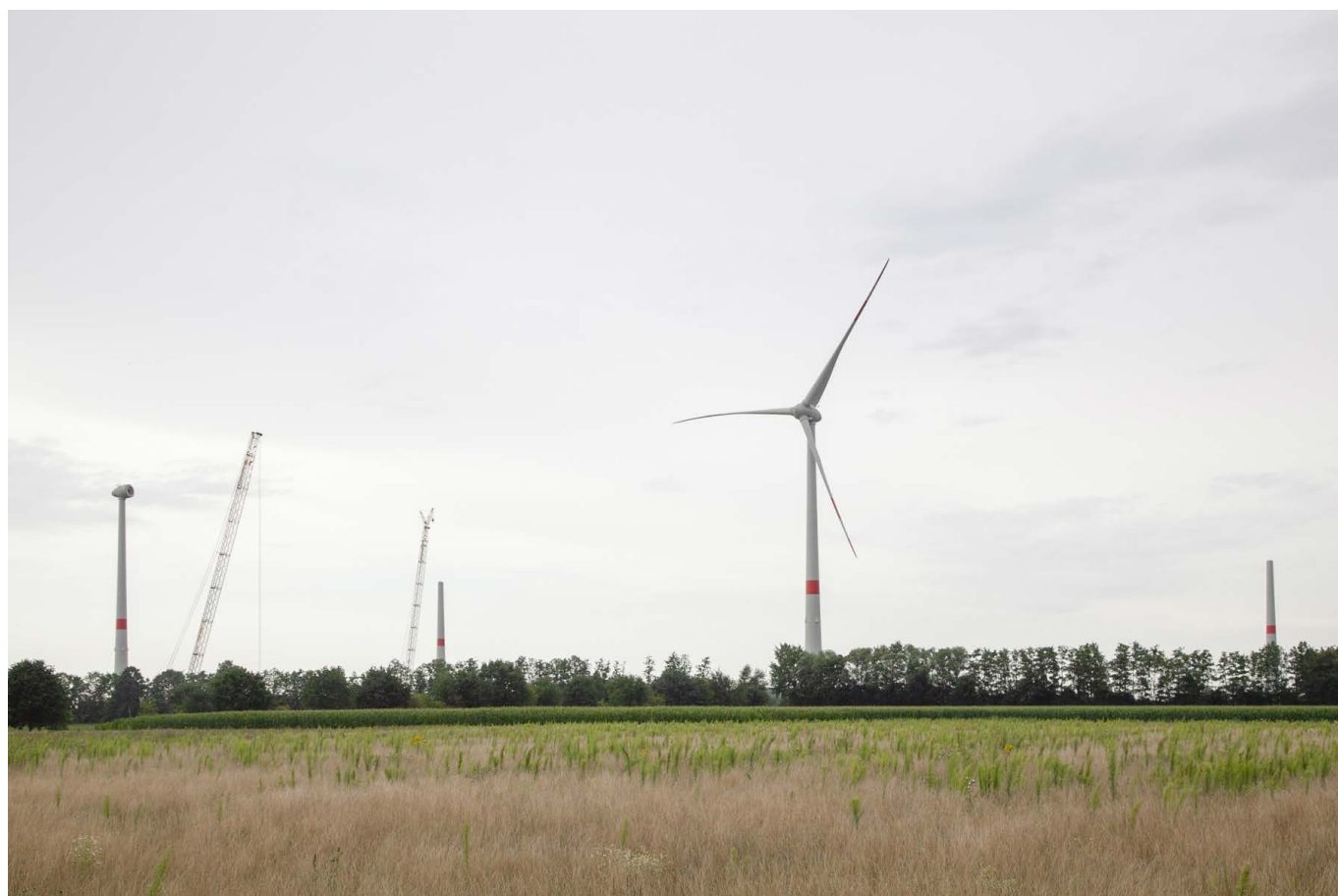
Windpark Baaler Bruch: WEA 7, 8, 9 und 10
