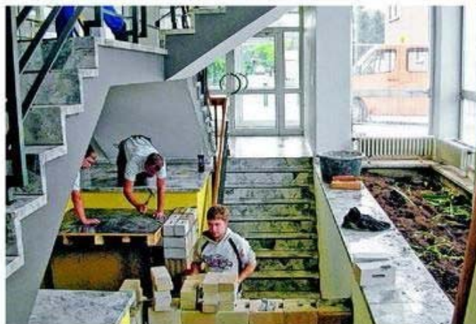
Der Bautrupp ist mit den Vorbereitungen für den Abbruch des Treppenhauses beschäftigt. Am Wochenende soll die alte Treppe weichen.
