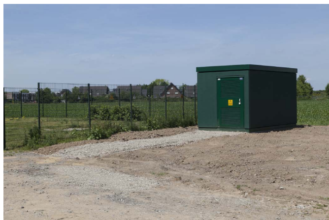
Die fertige Übergabestation am Willy-Brandt-Ring
