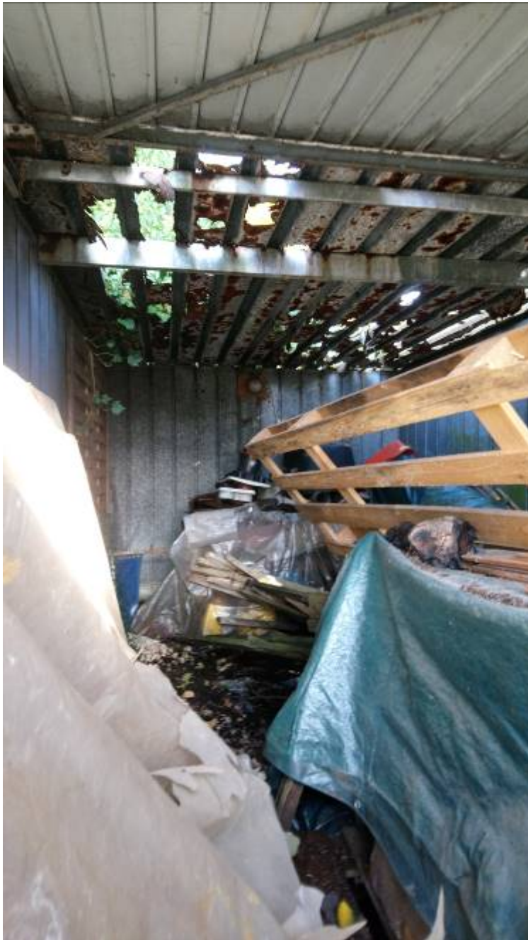
Bild 9: Blick in die Garage mit beschädigtem Flachdach (eigene Aufnahme, 26.10.2022)
