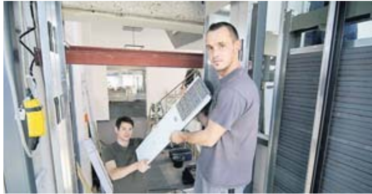
Die Monteure Stefan Kummetat und Dennis Czernio montieren im Auftrag den neuen Aufzug. RP-ARCHIVFOTO: SEYBERT
