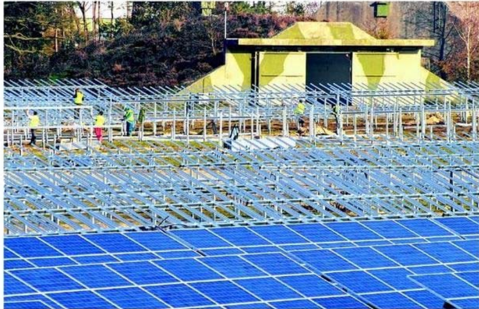
Zwischen Bunkern , Wald und Landebahn erstreckt sich der Solarpark des Airport Weeze . Die Anlage wird Ende Dezember fertiggestellt und soll ab 2012 jährlich 13 Megawatt Strom produzieren. RP-FOTO: GERHARD SEYBERT
